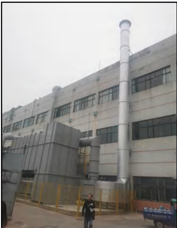
现有工程-RTO 废气处理设施+25m 排气筒
