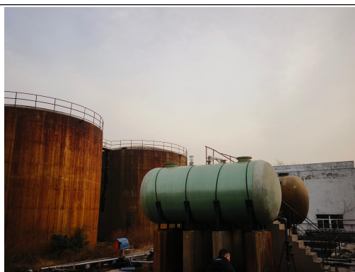
化水车间北侧设备
